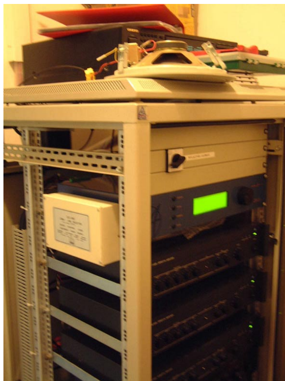
rack z urządzeniami systemu rozgłoszeniowego
