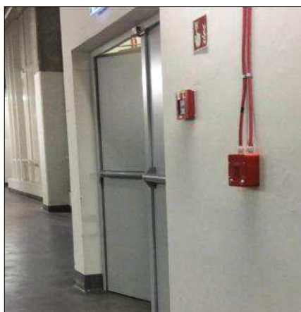
Fot. 3. Stacja typu B w korytarzu ewakuacyjnym galerii handlowej
