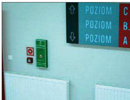
Fot. 2. Zastosowanie stacji typu B interkomu ratunkowego na klatce schodowej w dużej hali widowiskowej
